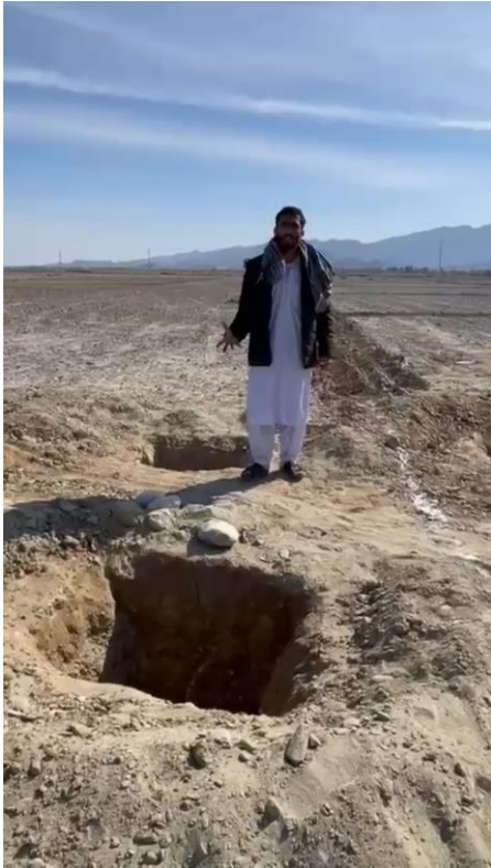
محل نصب ترانس برق روستا
